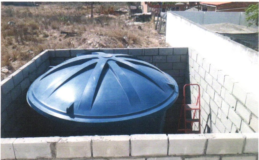
Foto 06- RESERVATÓRIO DE POLIETILENO 10.000 LITROS
