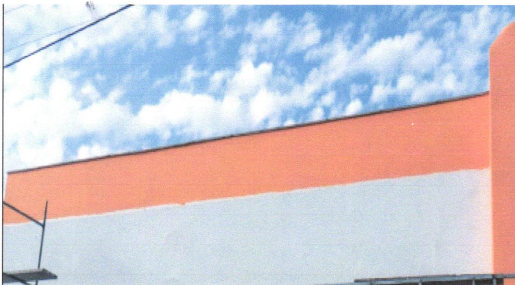
FOTO 26 – Chapim de concreto pré-moldado
